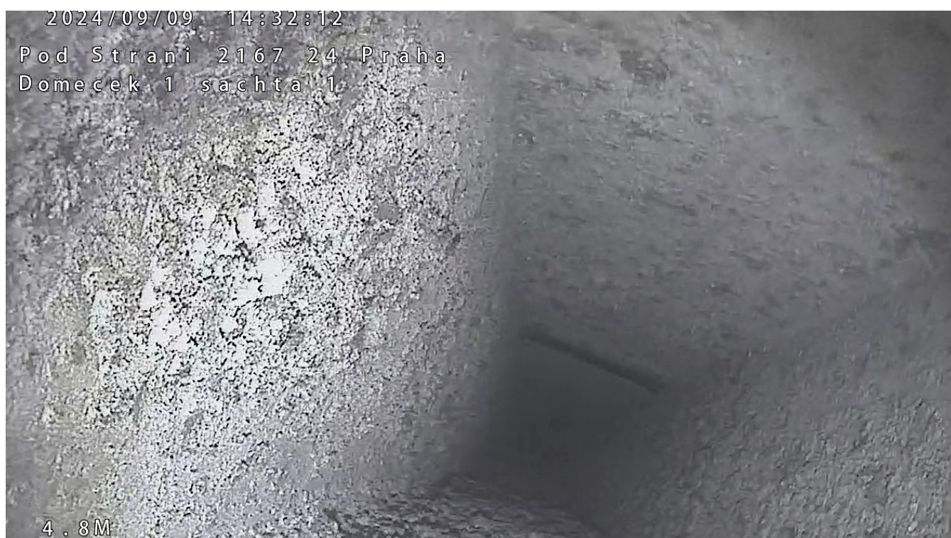
Extrémní znečištění stěn šachty.
