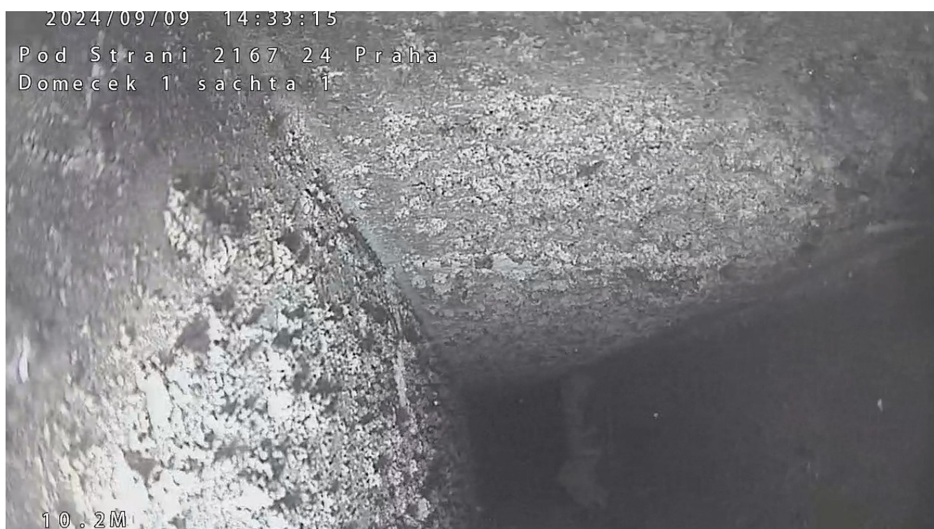
Extrémní znečištění stěn šachty.
