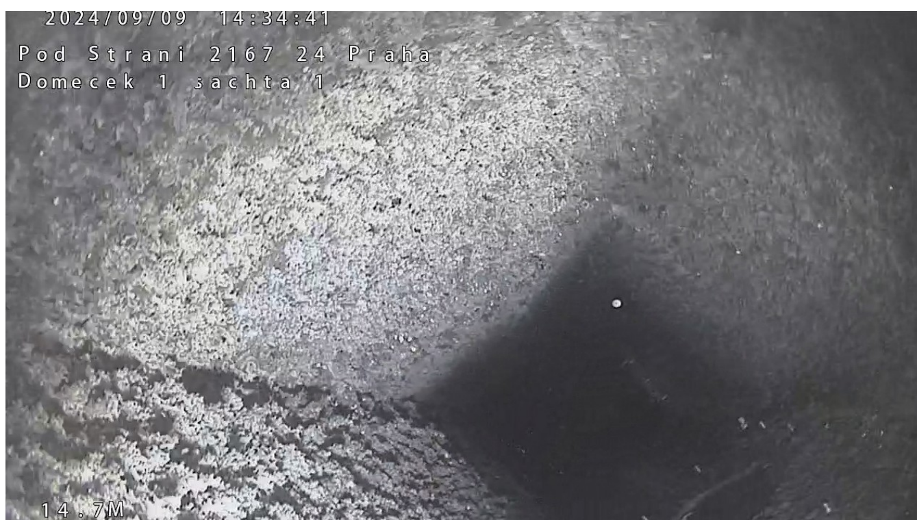
Extrémní znečištění stěn šachty.
